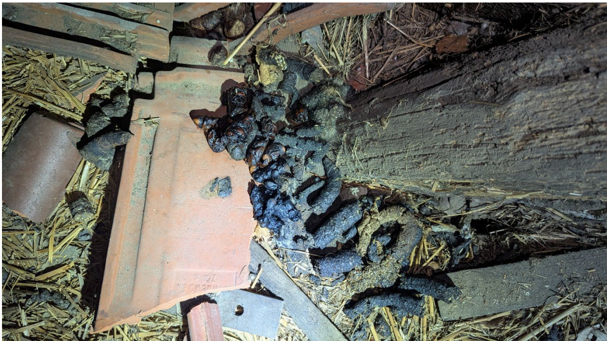
Abbildung 5: Große Mengen Waschbär-Kot im Bereich des Dachstuhls.
